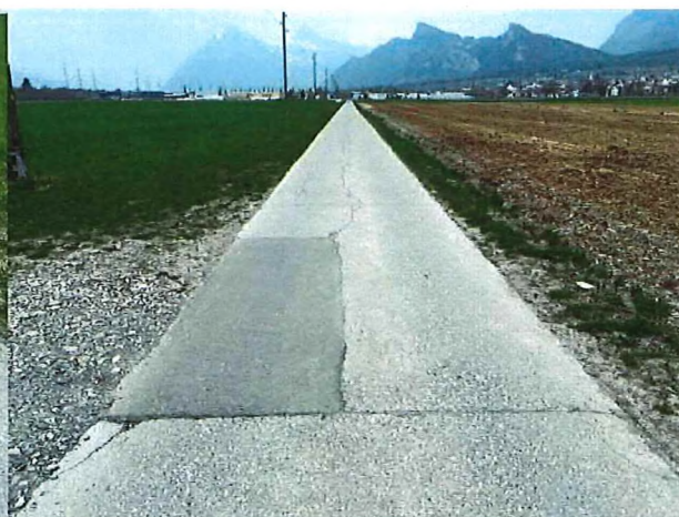
Abbildung 4: Risse Betonplatte, Belagsflick Abschnitt Hanfländerweg - Weiherweg
