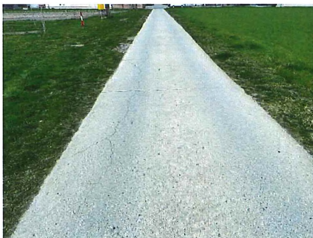
Abbildung 3: Risse Betonplatte Abschnitt Industrie - Kabisgartenweg
